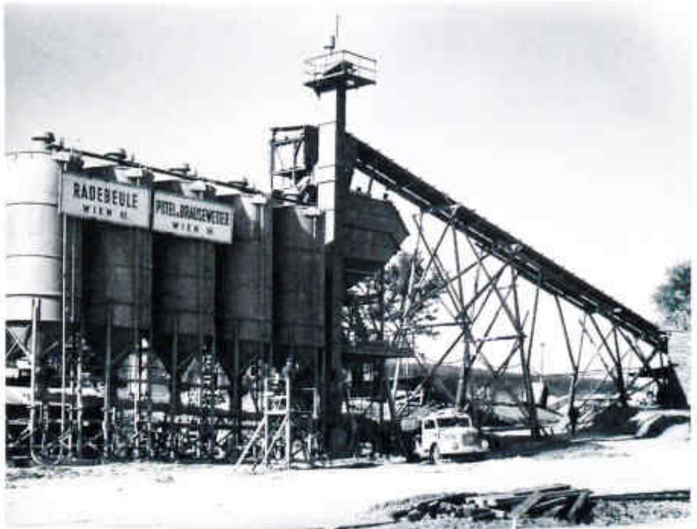
A1 Steinbitumast Baustellen-Mischanlage
