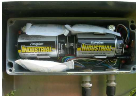
Austausch der Batterien und Trockengel- packungen
