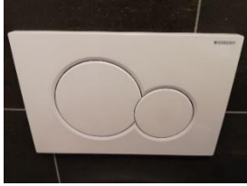
Bild 10: Tasten der Toilettenspülung.
