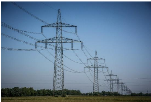
Bild 9: Stromleitungen. © Pixabay. Bildquelle: https://cdn.pixabay.com/photo/2015/06/10/15/02/power-lines-804880_960_720.jpg 10.03.2022
