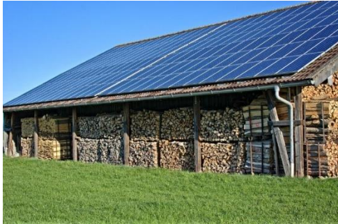
Bild 8: Photovoltaikanlage auf einem Dach. © Pixabay. Bildquelle: https://cdn.pixabay.com/photo/2016/10/4/11/19/50/energy-1322810_960_720.jpg 109.03.20221
