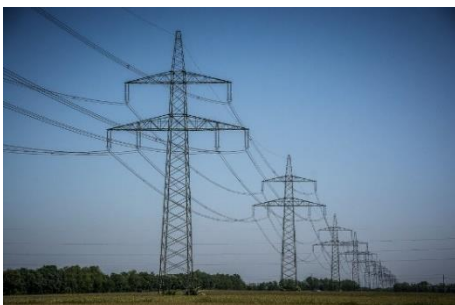
Bild 5: Stromleitungen. © Pixabay. Bildquelle: https://cdn.pixabay.com/photo/2015/06/10/15/02/power-lines-804880_960_720.jpg 109.03.20221
