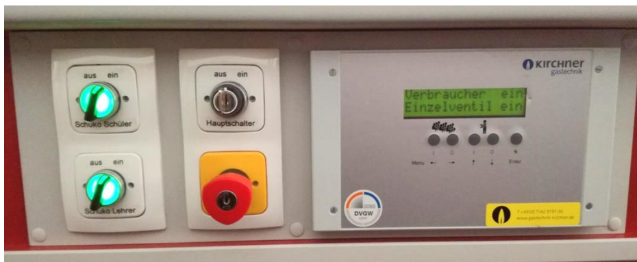
Abbildung 21 - Schaltpult für Strom und Gas am Arbeitsplatz des/ der Chemie-Lehrenden. Foto: Böhm
