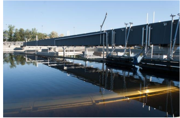
Abbildung 7: Nachklärbecken in Gössendorf
