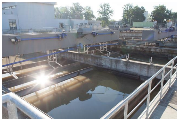
Abbildung 8: Sand- und Fettfang in Gössendorf
