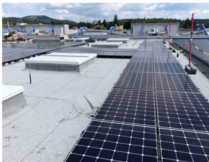
Abbildung 7: Photovoltaikanlage Universitätsbibliothek Bild 2
