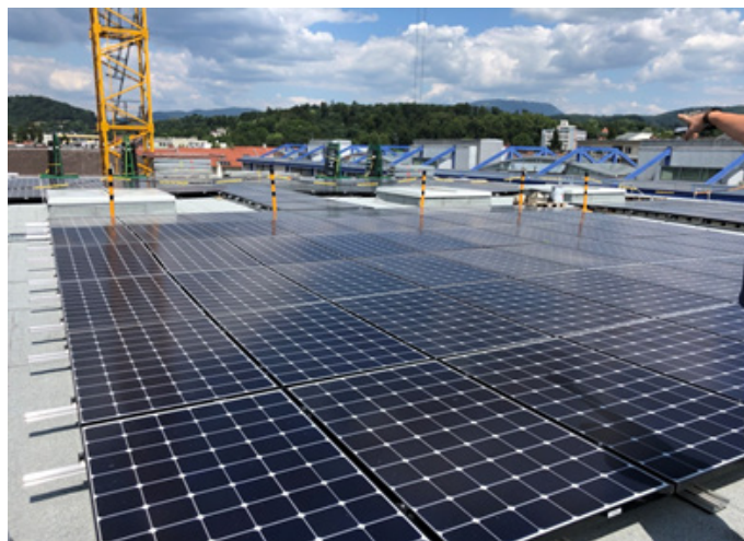
Abbildung 6: Photovoltaikanlage Universitätsbibliothek Bild 1
