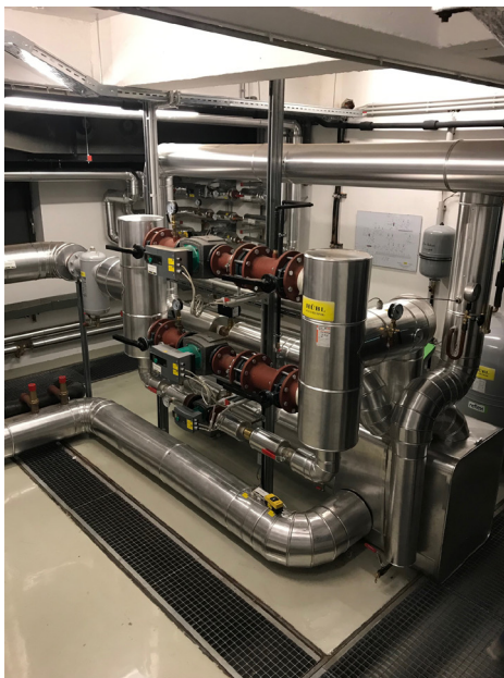
Abbildung 5: neue Heizungsanlage, Heinrichstraße 28
