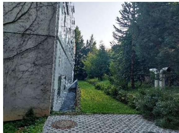
Abbildung 216: Gebäuderückseite, mit abgestorbenen Kletterpflanzen auf der Fassade.
